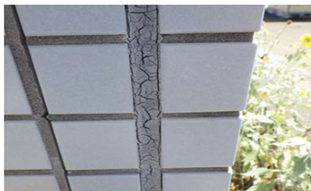
本庁舎別棟：外壁全体（シール劣化）
