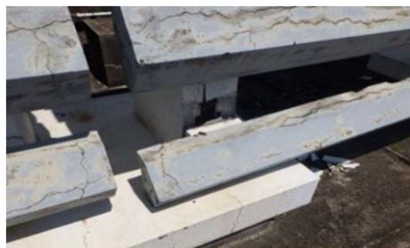
本庁舎：外部仕上 （目隠しポータ脱落の恐れ）
