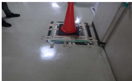
本庁舎：排水（蓋の戸締り不良）
