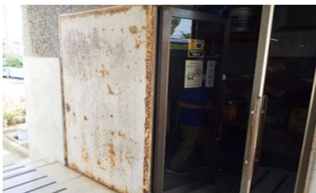
本庁舎：防災 （発錆及び開閉不良の可能性あり）
