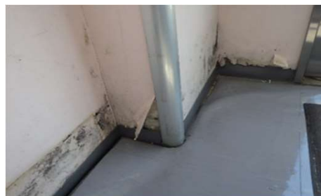
本庁舎別棟：内壁（壁面より雨漏り）
