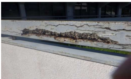
本庁舎：外部仕上（発錆による爆裂）
