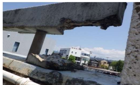
本庁舎：外部仕上 （手摺コンクリート脱落の恐れ）
