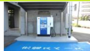
電気自動車用急速充電ステーション
