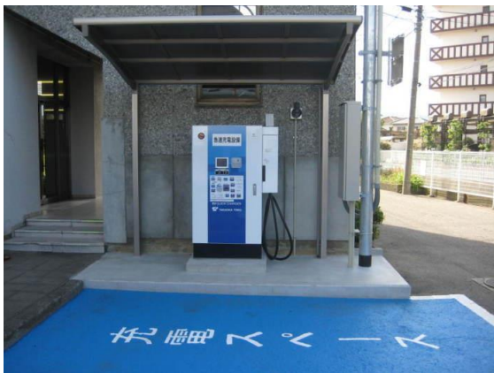
■電気自動車用急速充電ステーション (阪南市役所駐車場)
