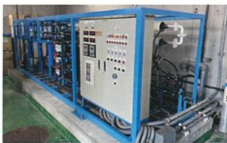
海水淡水化装置
