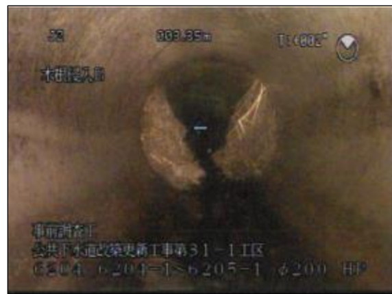
※ 木の根が管渠に侵入しています。
