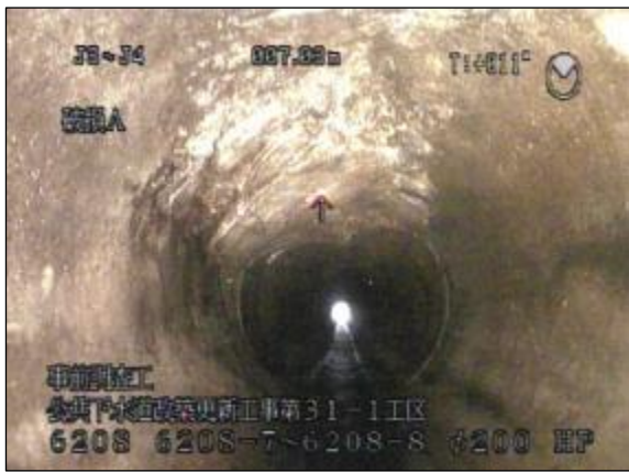
※ 管渠の上部が破損しています。
