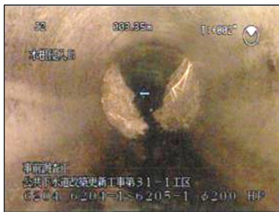
※ 木の根が管きよに侵入しています。
