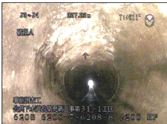
※ 管きよの上部が破損しています。
