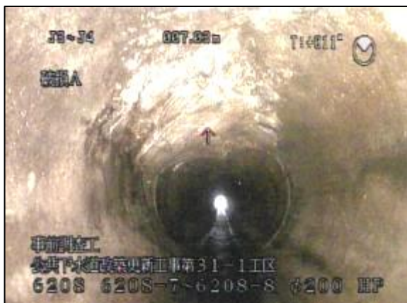
※ 管渠の上部が破損しています。
