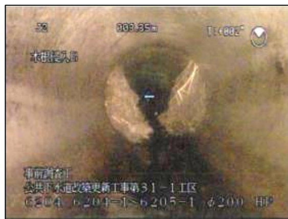
※ 木の根が管渠に侵入しています。
