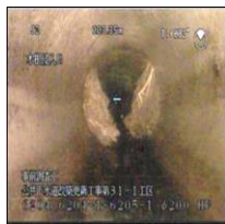
* 管に木の根が侵入
