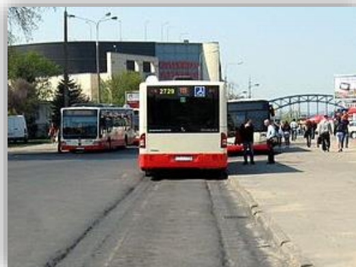
参考図-3 わだち掘れ状況
