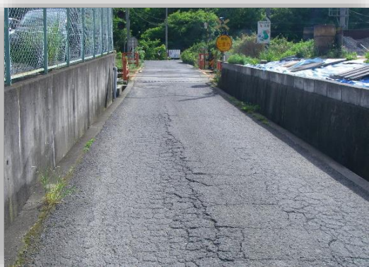
参考図-2 ひび割れ状況
