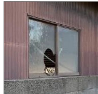
窓が割れた管理不全空家
