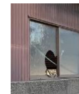
窓が割れた管理不全空家
