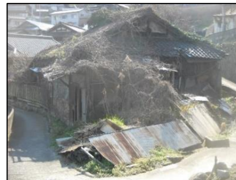
特定空家 (老朽化が進み、倒壊等の危険性大)
