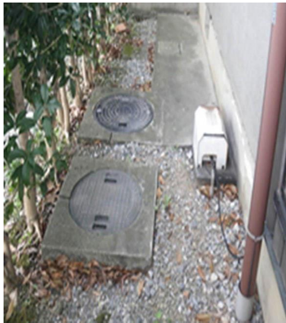
既存の単独処理浄化槽写真例
